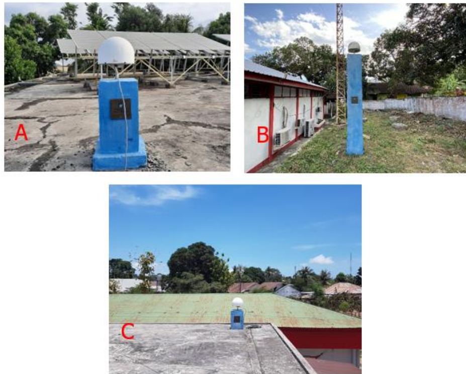
Gambar 2. Stasiun GNSS CORS CKAL (A), CLWB (B), dan CKUP (C).
